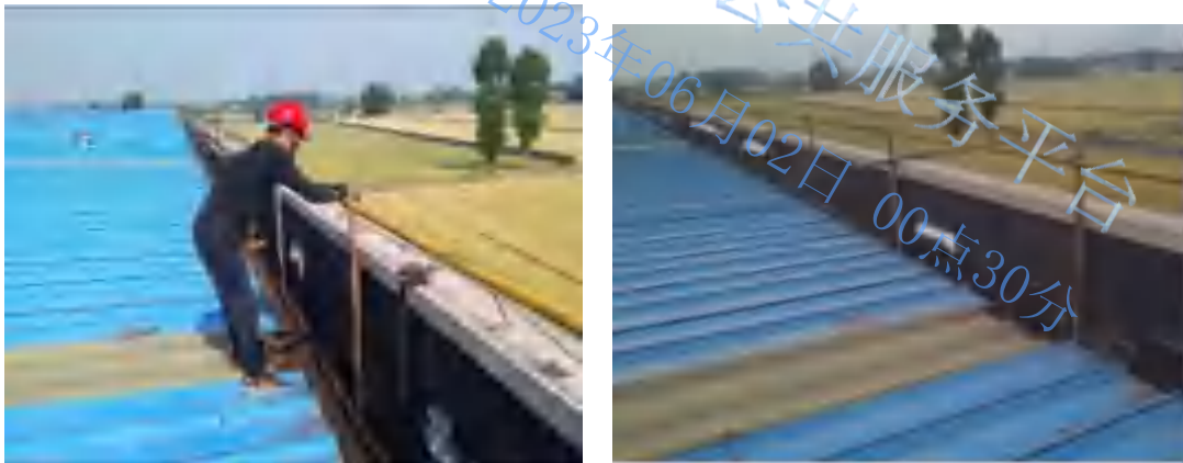
图 5.3 临时安全护栏实例
